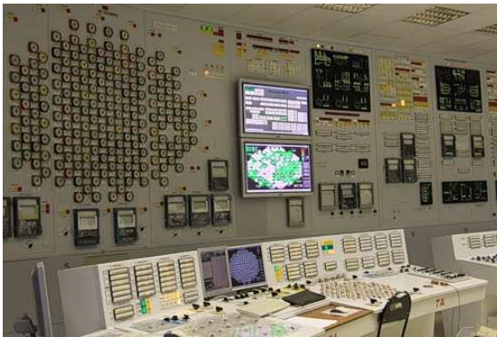
Рис. 23 Пульт управления электростанцией
